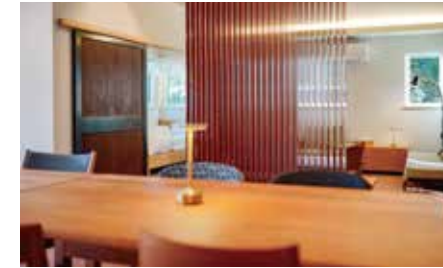
写真中央上の赤いパネルが輻射式冷暖房「ピーエス」
